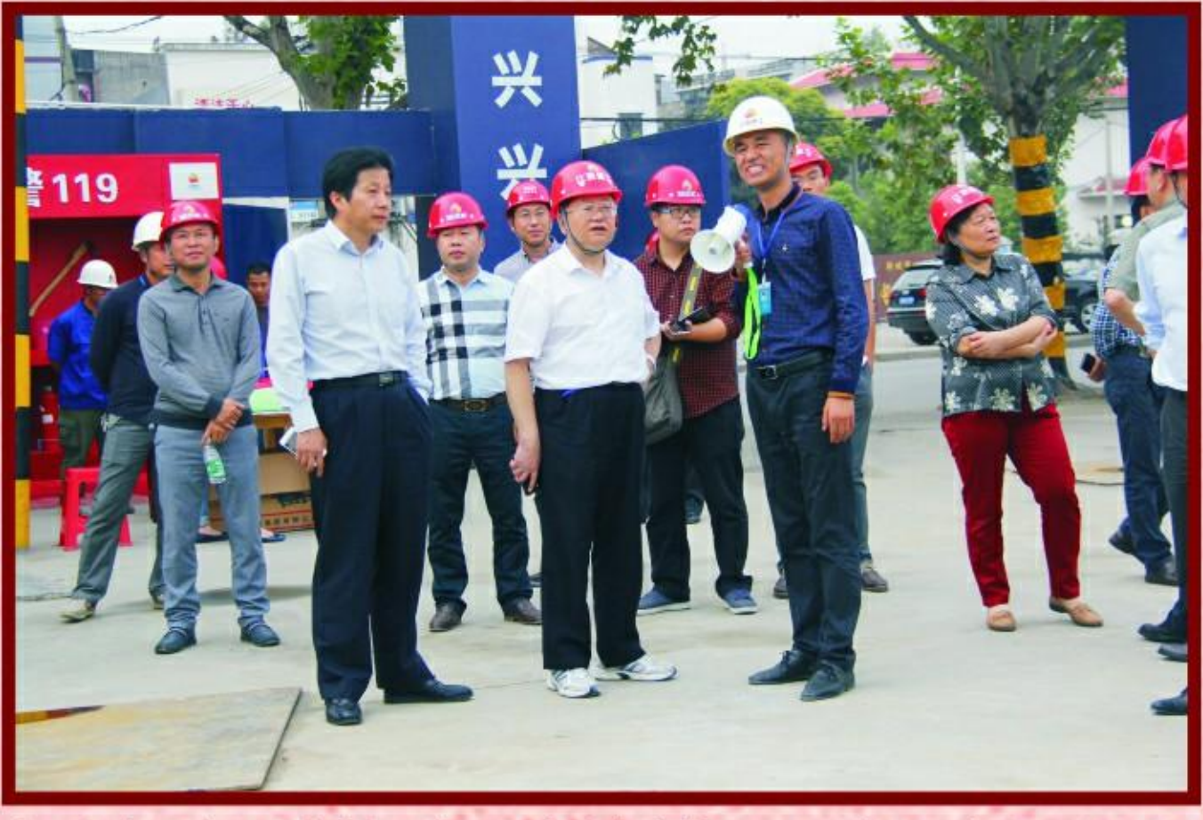
省人大城环委主任委员杨三典一行实地查看集团公司“尚风、尚水”施工现场
